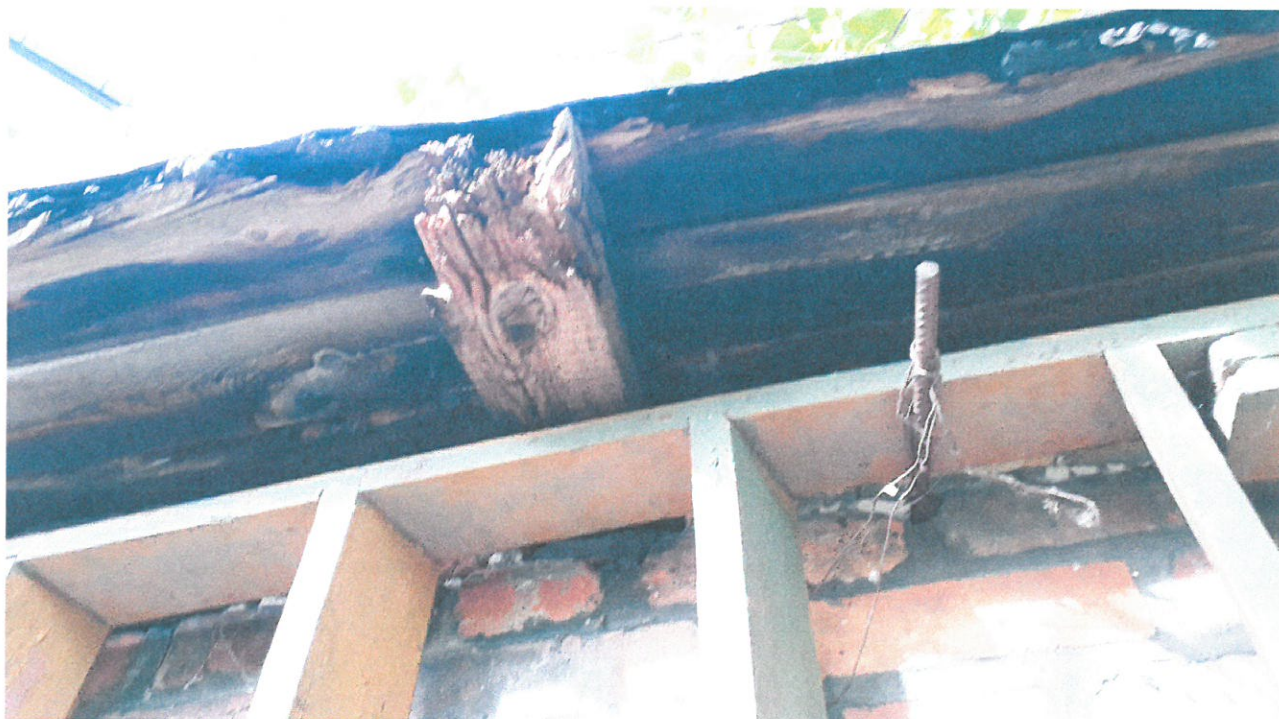
Zdj.2 Korozja biologiczna elementów drewnianych dachu
